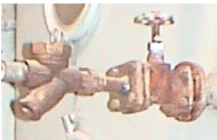
Mỗi khoang của máy sấy có đường xả nước ngưng
